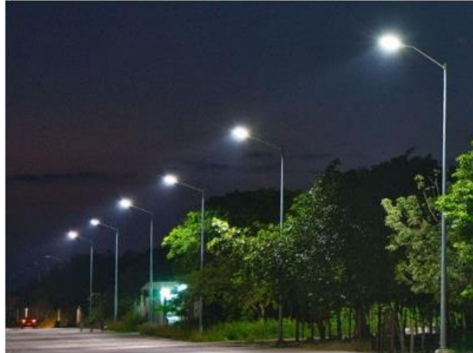
Ilustración 24: Iluminación Pública Solar. Fuente: internet.
